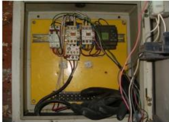
FIGURA 3.4 TABLERO DE CONTROL
