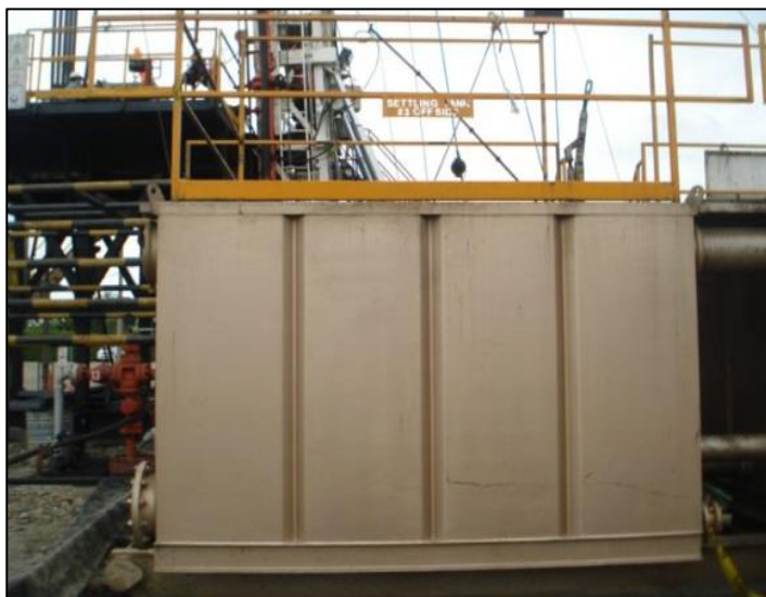
Figura 2.17: Tanque “La Trampa” para recolectar el fluido proveniente del pozo. Con capacidad de 100 bls.
