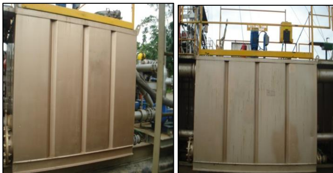
Figura 2.15 y 2.16: Tanques de asentamiento #1 y #2. Capacidad: 100 bls.
