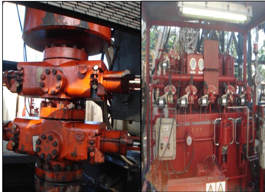
Figura 2.8 y 2.9: BOP y Acumulador.
