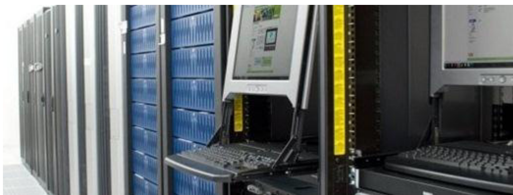
Figura 14: DATA CENTER ESPOL.
