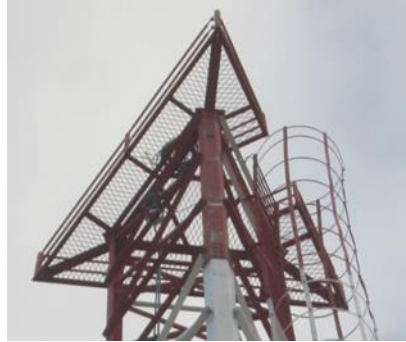
FIGURA 1.9 PLATAFORMA DE DESCANSO TORRE AUTOSOPORTADA
