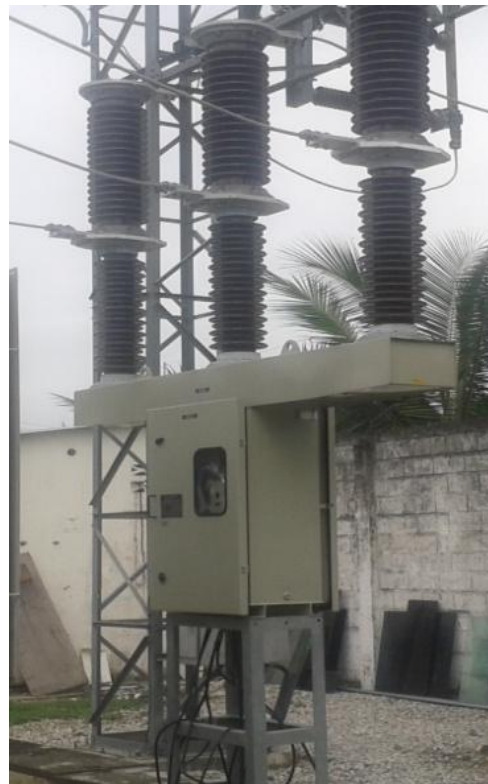
Figura 1.7 Interruptor en Gas SF6
