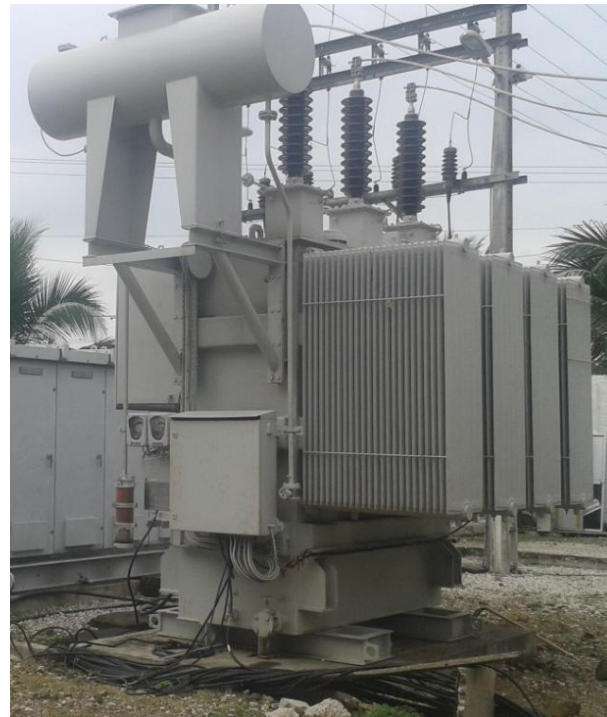
Figura 1.9 Transformador de potencia 69000/13800 V, marca PAUWELS
