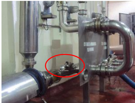
Figura 3. Bomba 1 del Tanque Buffer
