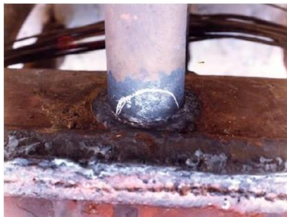
FIGURA 2.15 MECANISMO FALLA CORROSIÓN FATIGA
