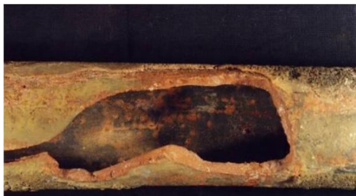
FIGURA 2.8 FALLA ATAQUE POR HIDRÓGENO.
