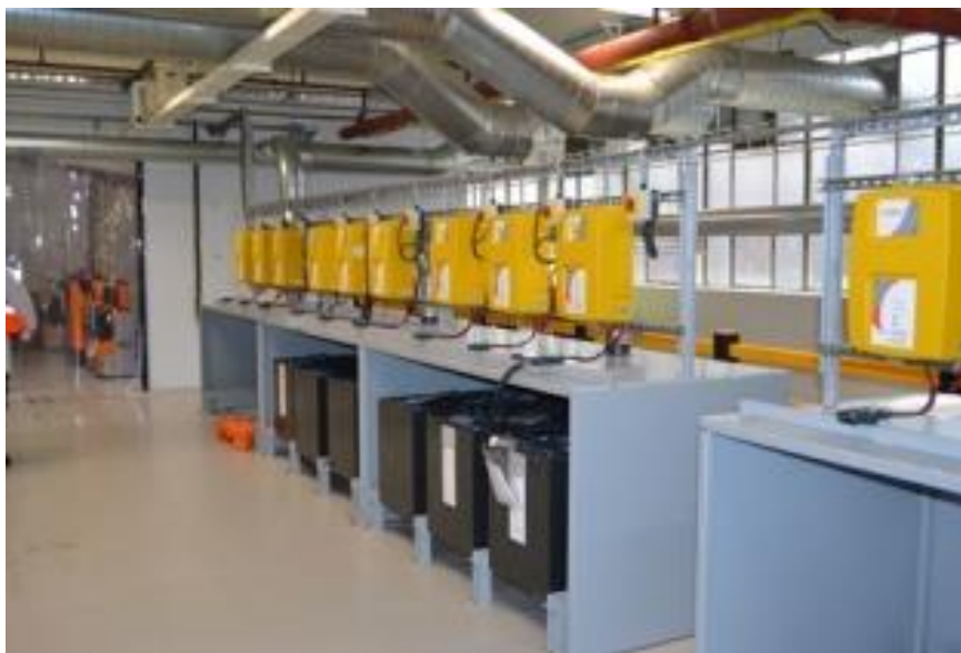
Figura 1.2 Los locales de carga de baterías deben contar con un sistema de ventilación eficiente y seguro.
