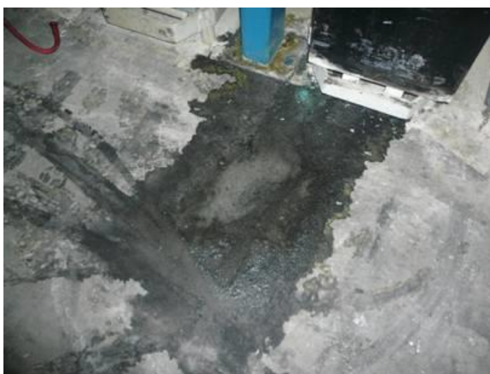
Figura 2.8 Derrame de ácido sulfúrico por la caída lateral de la batería.
