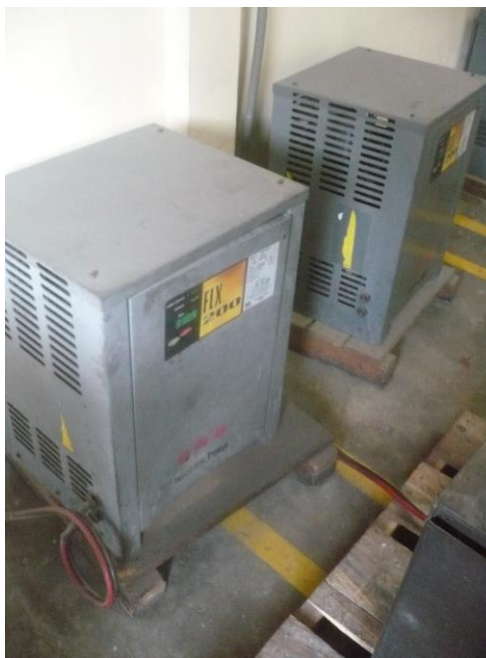
Figura 2.10 Bases soporte de baterías y cargadores son pallets de madera.
