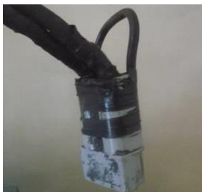
Figura 2.9 Conectores de baterías en mal estado por impacto / choque.
