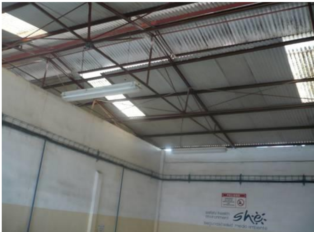
Figura 2.7 Cubierta del área. El traslape del techo permite la salida de aire.
