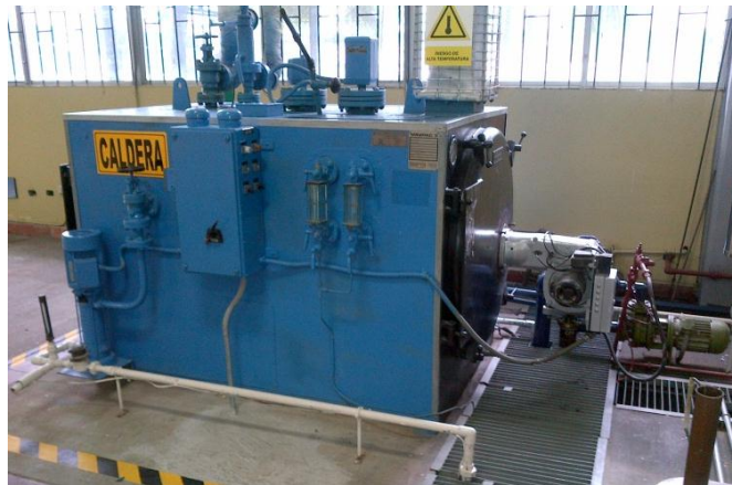
FIGURA 25. CALDERA DE 30 BHP A DIESEL.
