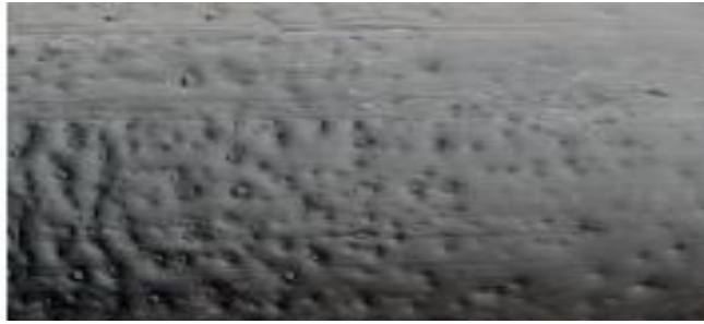
FIGURA 2.1 PRESENCIA DE POROS EN LA SUPERFICIE DE LA TUBERÍA
