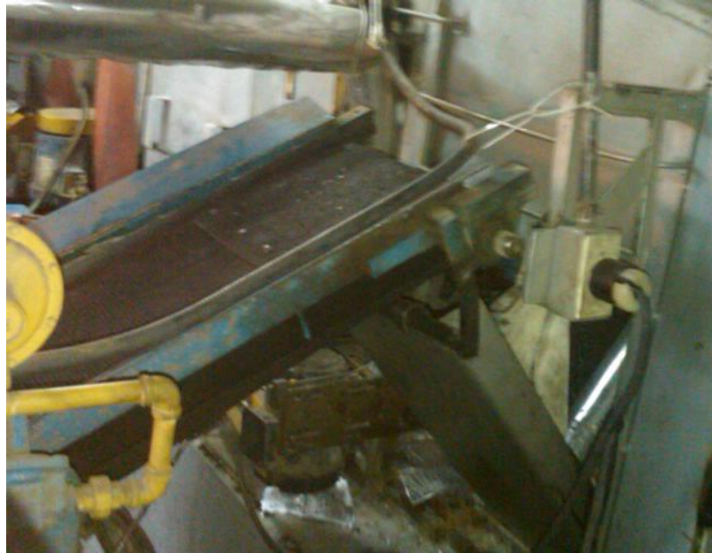
FIGURA 3.27 BANDA TRANSPORTADORA DE DESPERDICIOS
