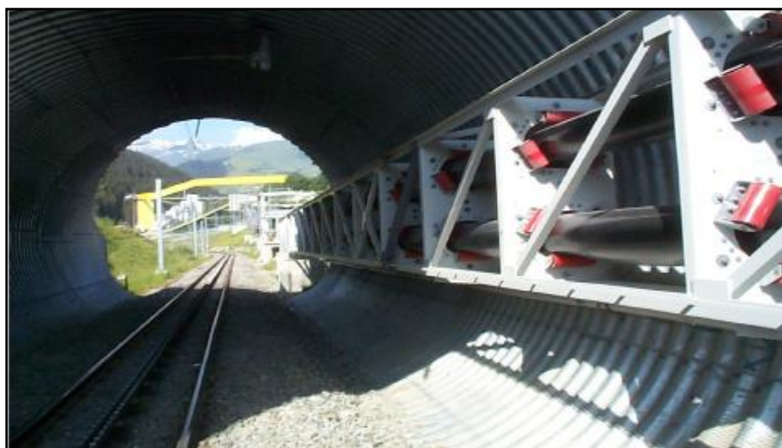
FIGURA 2.7 INSTALACIÓN TÚNEL GOTTHARD SEDRUM SUIZA [13]
