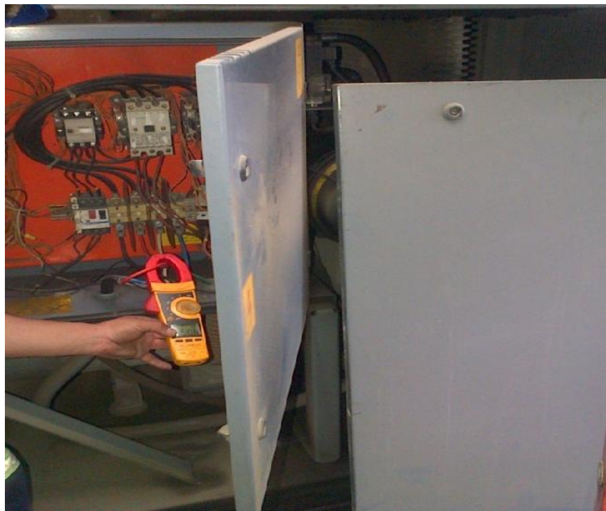
FIG. 4.9 TOMA DE AMPERAJE Y VOLTAJE EN COMPRESOR GA30
