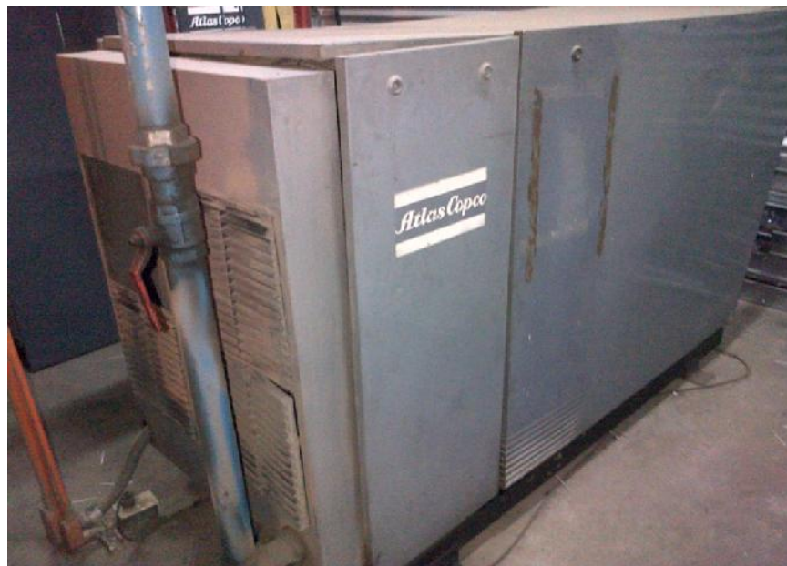
FIG. 2.11 COMPRESOR ATLAS COPCO DE 40 HP.
