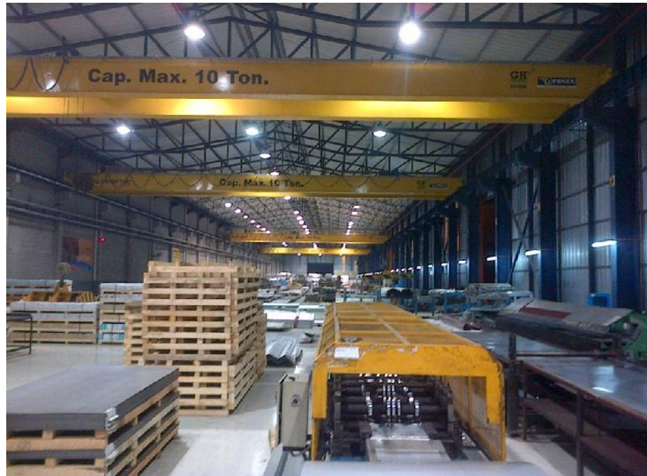
FIG. 4.7 PUENTES GRÚAS EN EL NUEVO GALPÓN
