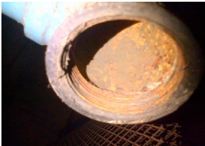
FIG. 4.2. TUBERÍA GALVANIZADA DE 2 PULGADAS DE DIÁMETRO
