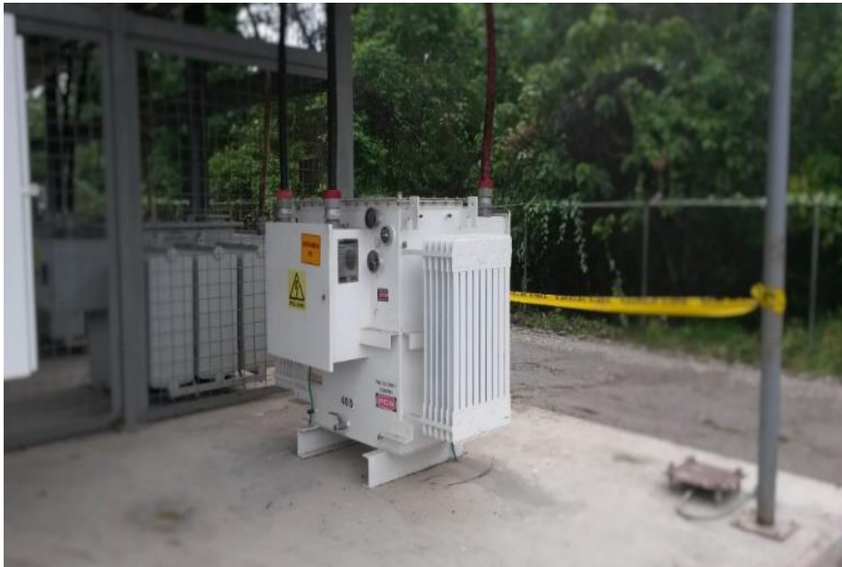
Figura 2.1. Transformador elevador. Fuente: Fernando Escandon – Petroamazonas EP
