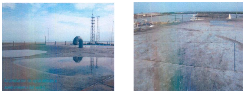
Figura 3.19 Condición de láminas de techo
