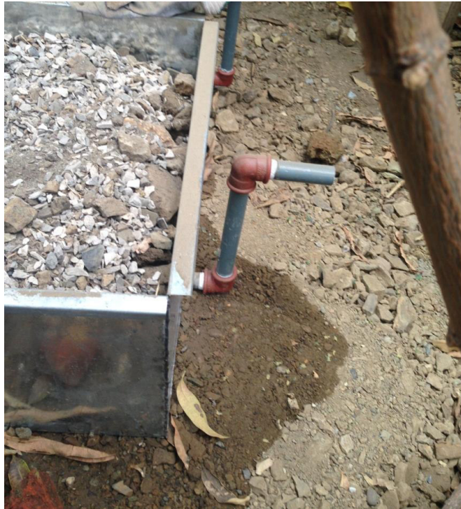
Conexión de tubería al final de los humedales, lugar donde se tomaron las muestras de agua
