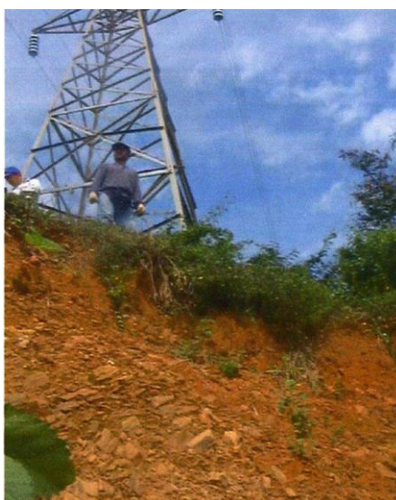
Foto 12 Deslizamiento de la capa meteorizada ocurrida en el sector Bastión Popular.
