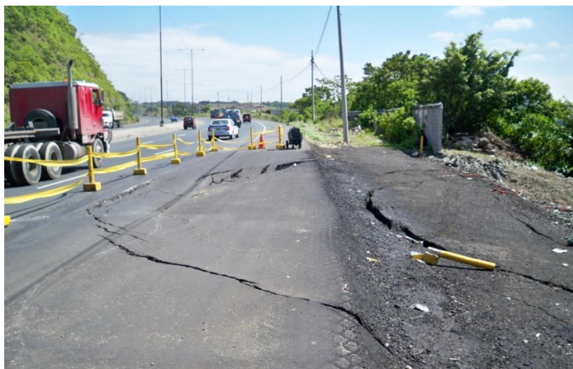
Foto 8 Deslizamiento al pie de la vía Perimetral que está construida sobre el depósito aluvial.
