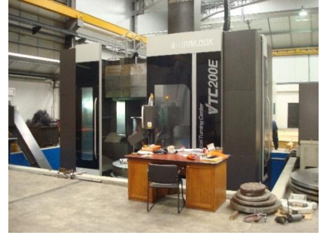
FOTO21.- NUEVA TECNOLOGIA INSTALADA
