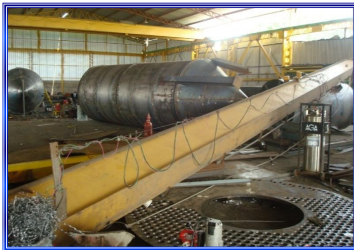
FIGURA 2.13: CAÍDA DE PUENTE GRÚA DE 5 TON.
