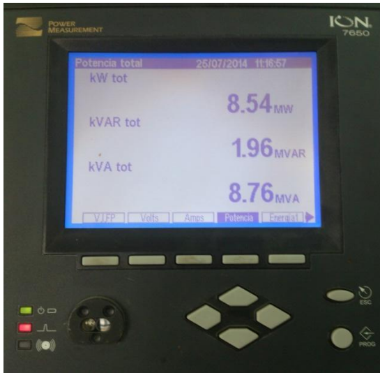
Figura 4. Medidor totalizador de todas las alimentadoras.
