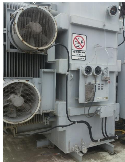
Figura 3 Transformador de Potencia de la S/E Milagro Sur
