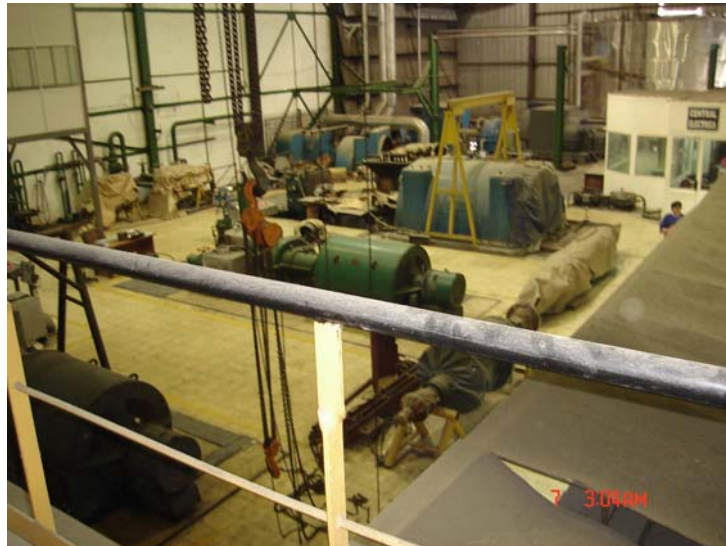
FIGURA 6-1. Central de generación eléctrica
