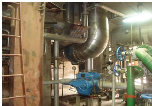
FIGURA 6-2. Entrada de tubería vapor a TG-4
