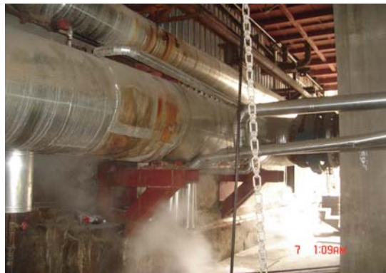
FIGURA 6-3. Tubería de vapor 600 PSI
