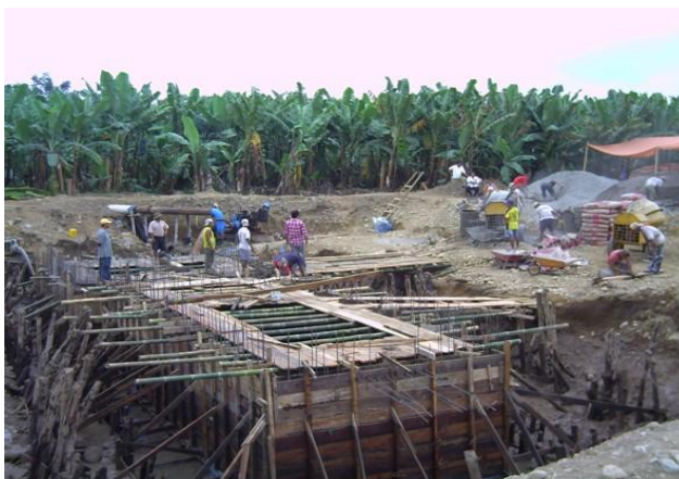
FIGURA 3.8.- REACTOR DE TRATAMIENTO DE AGUAS SERVIDAS CIUDADELA CIUDAD VERDE – MACHALA
