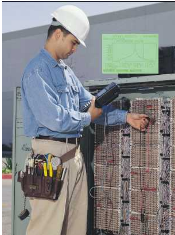
FIGURA 65: MEDICION EN UNA REGLETA DEL ARMARIO Fuente: Sunrise Telecomunicaciones
