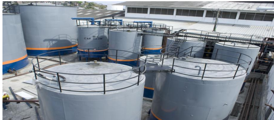
FIGURA 3.1 TANQUES DE ALMACENAMIENTO DE LUBRISA S.A
