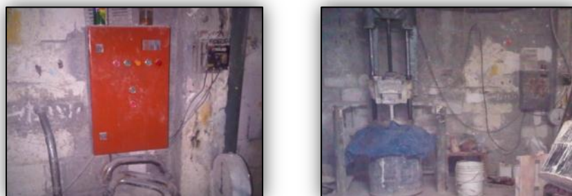
FIGURA 5.7. TABLERO DE CONTROL DE MÁQUINA MEZCLADORA
