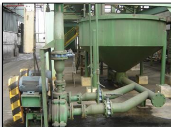
FIGURA 4.10. TANQUE DE LODOS
