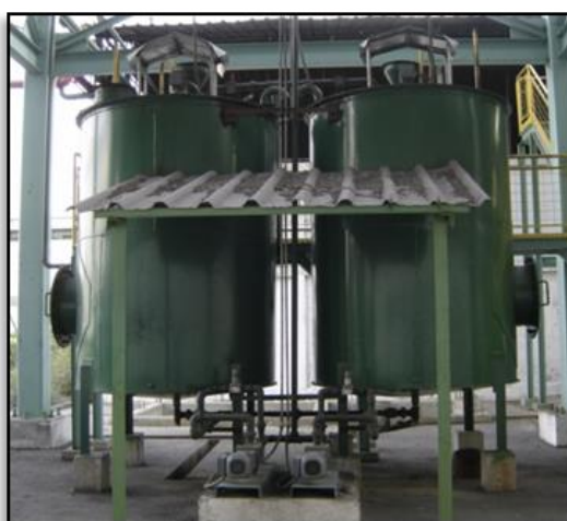
FIGURA 4.8. ESTACIÓN DE FLOCULANTE
