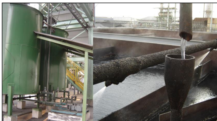
FIGURA 4.34. ESTACIÓN DE BOMBEO DE FLOCULANTE Y DOSIFICACIÓN DE FLOCULANTE A UNA DE LAS CELDAS.
