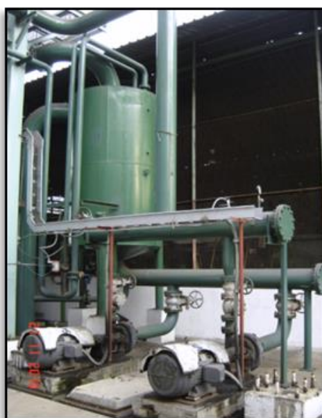
FIGURA 4.9. TANQUE DE AGUA TRATADA
