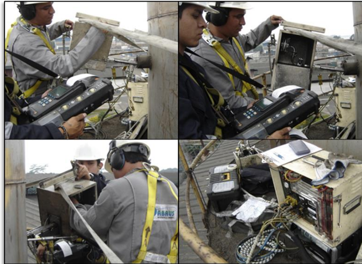
FIGURA 5.2. TÉCNICOS DE ABRUS CIA. LTDA. DURANTE MONITOREO DE GASES DE COMBUSTIÓN DE LA CALDERA #8.
