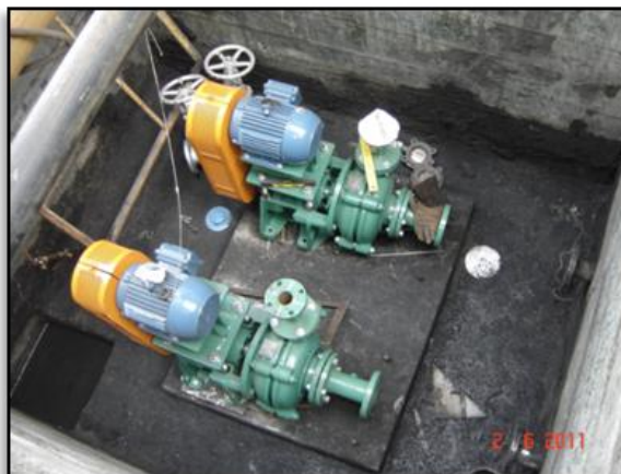
FIGURA 4.11. TANQUE DE DRENOS
