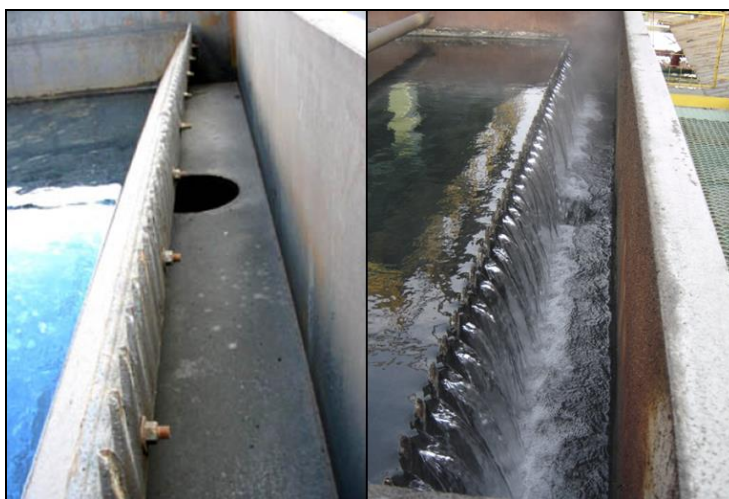
FIGURA 4.33. VERTEDERO DE CELDAS DE DECANTACIÓN. A LA IZQUIERDA SE OBSERVAN LOS PERNOS DE AJUSTE DE ALTURA.
