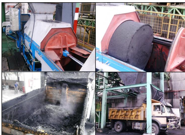
FIGURA 4.45. PRENSA DESAGUADORA EN PLENA OPERACIÓN.
