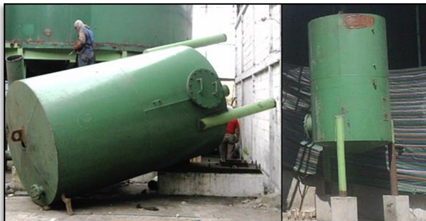
FIGURA 4.28. TANQUE DE AGUA TRATADA.
