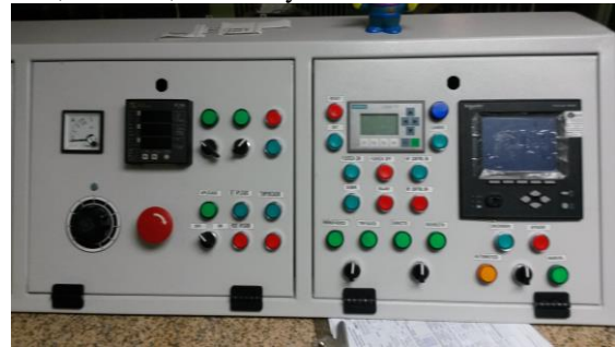
Figura 6. Implementación del tablero de control y mando.
