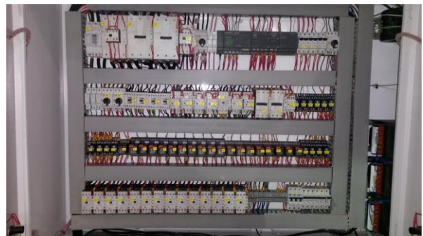
Figura 7. Implementación del tablero de Fuerza.
