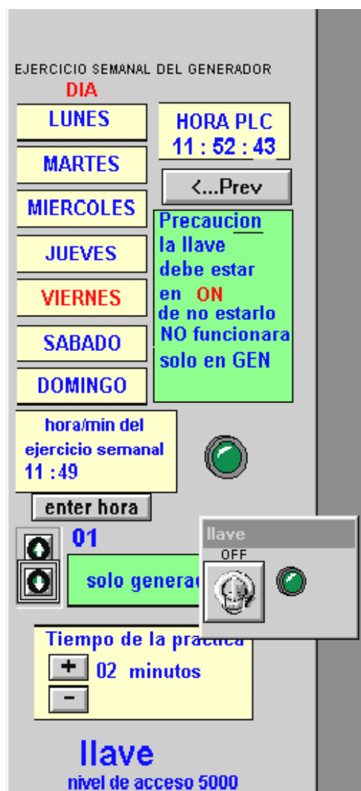
Figura 5.5 Pantalla de control del generador
