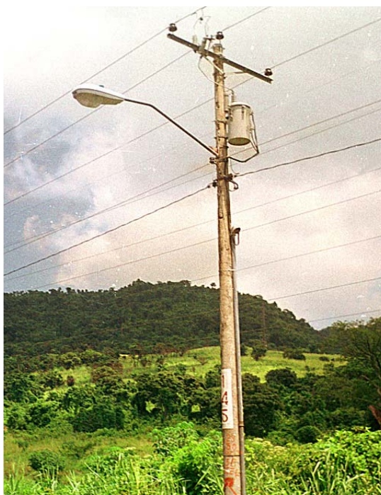
FIGURA 1.1 Poste de distribución
