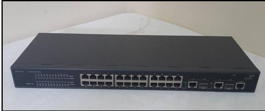
Figura 3.20 Switch para conexión de MSC1 y MSC2
