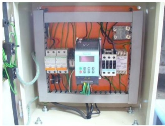
FIG. 2.22 FOTOGRAFÍA DEL MONTAJE TERMINADO DE COMPONENTES DEL TABLERO DE CONTROL
