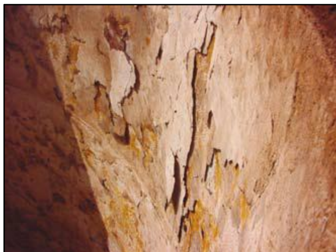
FIGURA 1.6. CORROSIÓN INTERNA EN UNA CHIMENEA. [16]
