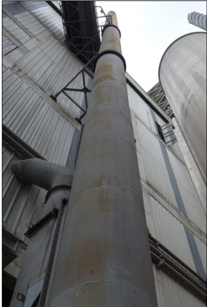
FIGURA 2.4. CORROSIÓN GENERALIZADA EN LA CHIMENEA
