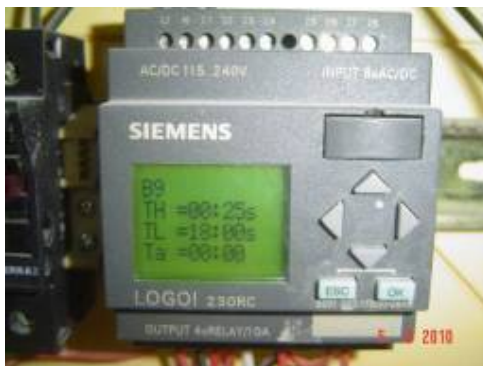
Entrada del Parámetro B9 al PLC
