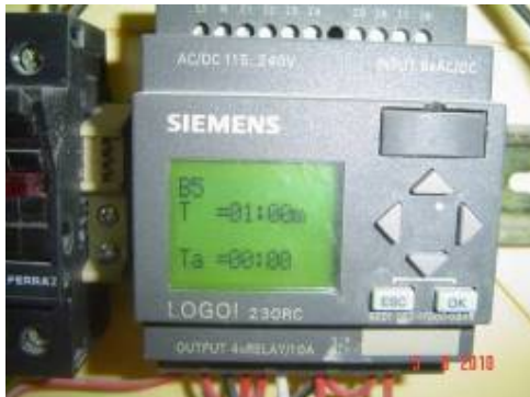
Entrada del Parámetro B5 al PLC
