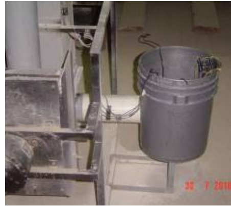
Tanque conectado al Filtro
