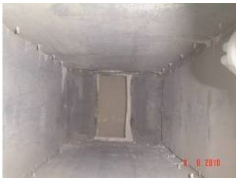
Vista Interior del Filtro
