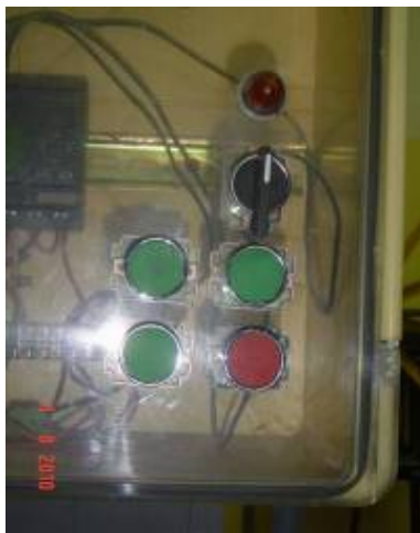
Switch del PLC - Cierra
