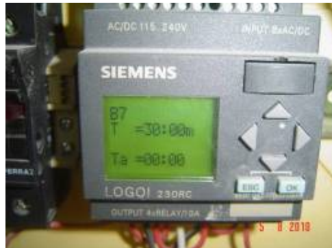
Entrada del Parámetro B7 al PLC
