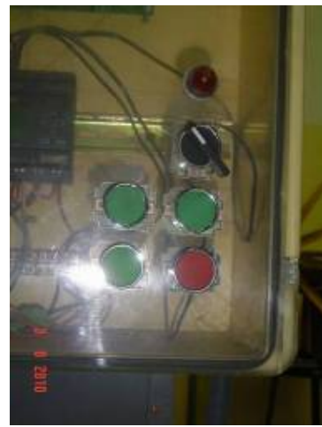
Switch del PLC - Abre
