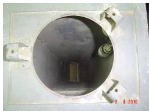
Vista Superior del Filtro
