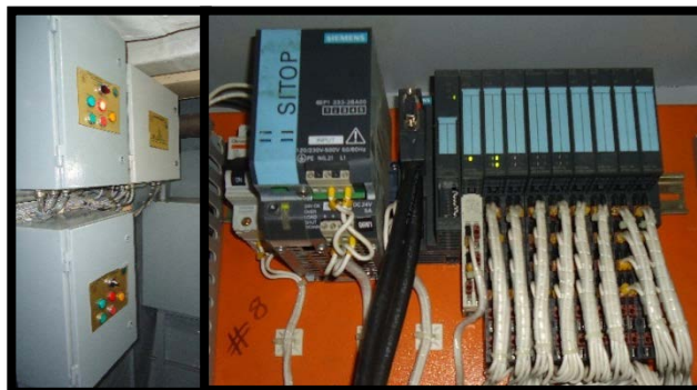
Figura #3: Tableros y equipos de control adquiridos
