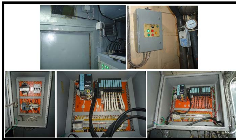
Figura #6: Cableado interno e instrumentación
