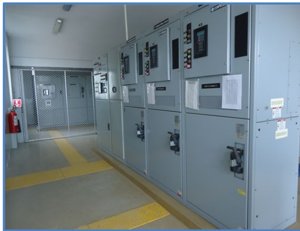
Figura 9.- Tablero de Motores Estación EB 3
