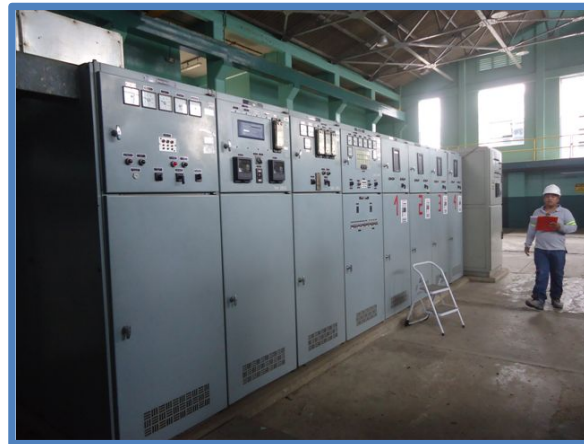
Figura 5.- Tablero de Motores Estacion EB1
