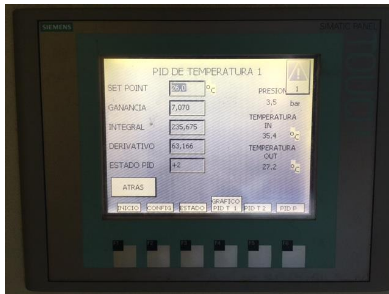
Figura 3. Imagen del Simatic Touch Panel montado en el tablero
