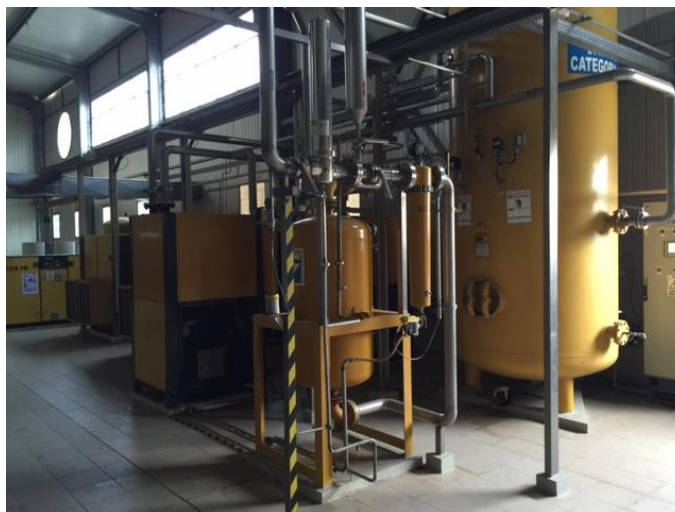
Figura 18. Imagen de la sala de máquina de Ambev donde se instaló la Torre de enfriamiento
