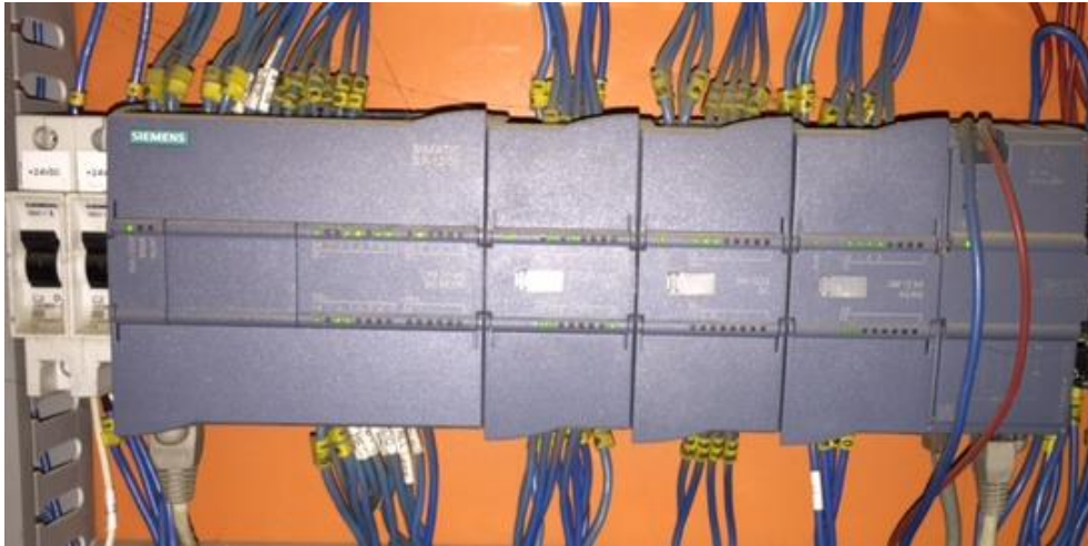
Figura 2. Imagen del PLC Siemens S7-1200 montado en el tablero
