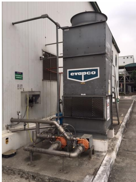
Figura 17. Imagen de la torre de enfriamiento instalada en Ambev
