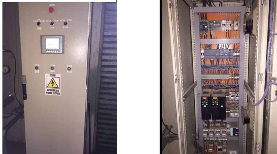
Figura 4. Tablero de control de la Torre de Enfriamiento
