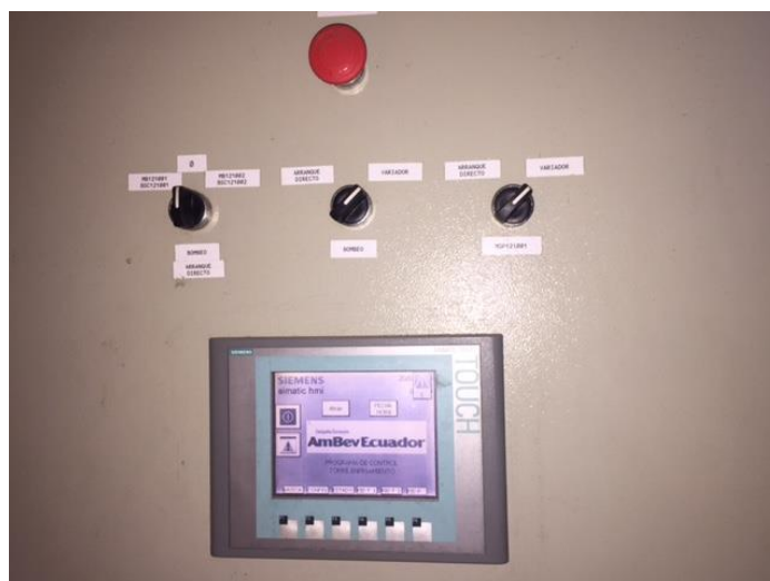
Figura 20. Imagen de parte frontal del tablero con los selectores
