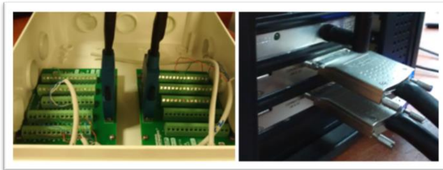
FIGURA 1.13. DETALLE DE LA CAJA DE CONEXIONES, BORNERAS Y TARJETAS DE ADQUISICION DE DATOS
