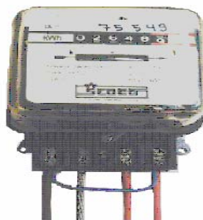
FIGURA 25. MEDIDOR CON BORNERAS PUENTEADAS.
