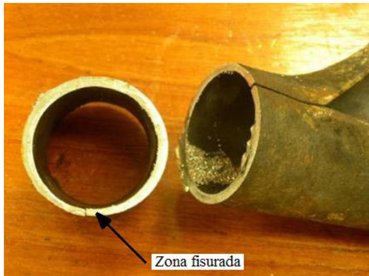
Figura 1.22 DISMINUCIÓN DE ESPESOR EN ZONA FISURADA
