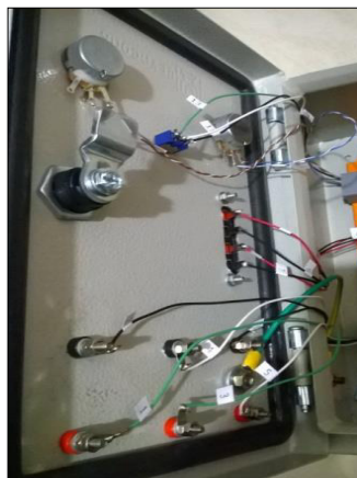
FIGURA. 2.12. ETIQUETADO DE LOS CABLES.
