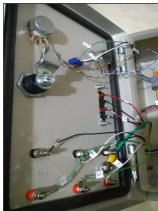
FIGURA. 2.12. ETIQUETADO DE LOS CABLES.
