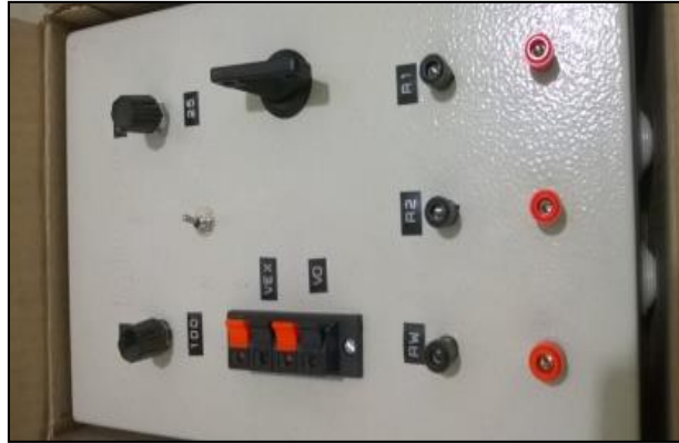
FIGURA. 2.13. VISTA FRONTAL DEL PANEL DE CONTROL DEL EQUIPO CON SU DEBIDO ETIQUETADO.
