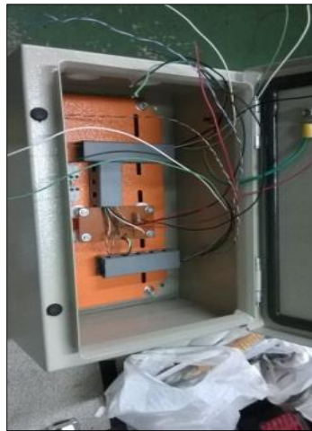
FIGURA. 2.11. CAJA CON LA PLACA DE BAQUELITA INSTALADA.
