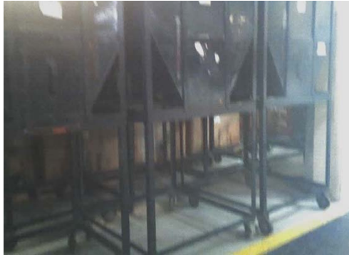
FIGURA 1.3 ÁREA DE EQUIPOS DE ALMACENAMIENTO
