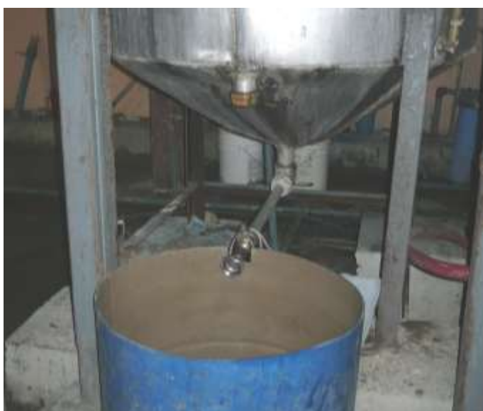
FIGURA 1.4. TUBERÍA DE DESCARGA DEL TANQUE DE MEZCLA
