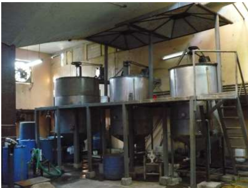
FIGURA 1.1. TANQUES DE MEZCLA
