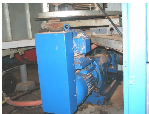
FIGURA 4.10. BOMBA DE CARGA DE PRENSA
