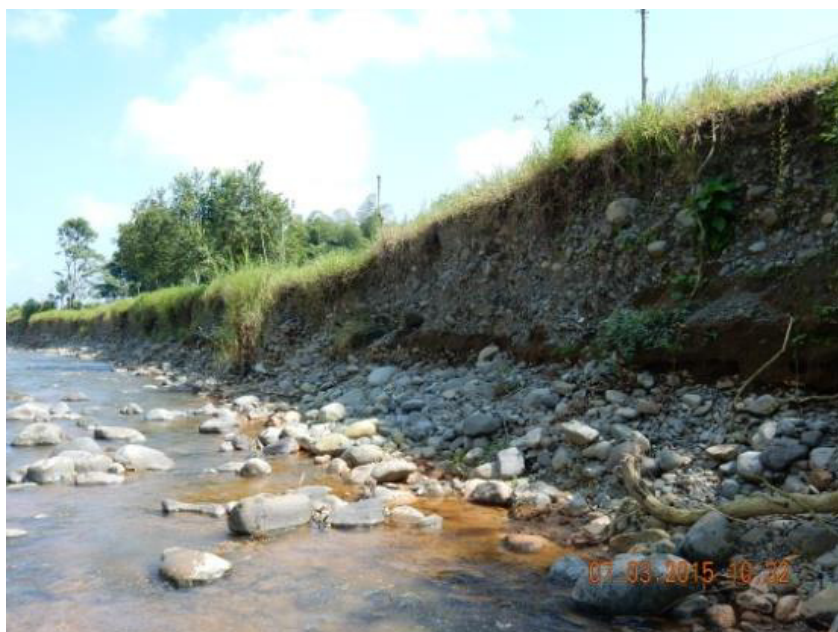
Fotografía 3.- Deslizamientos transversales en las partes bajas de la Cuenca Tomado por el autor
