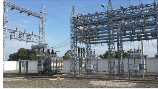
Figura 2: Vista interior de la Subestación Baba
