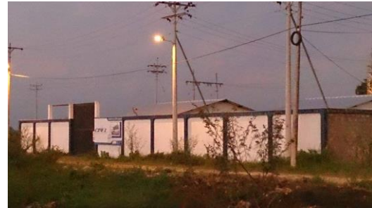
Figura 3: Vista exterior de la Subestación Baba
