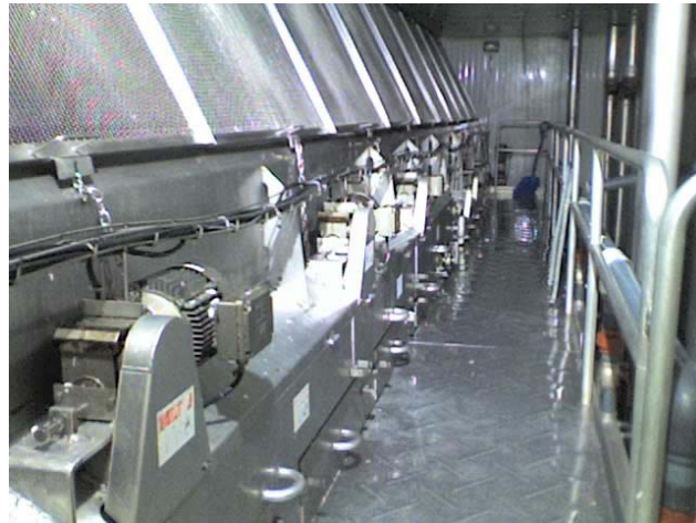
Figura 3.2 Foto del Túnel de congelación
