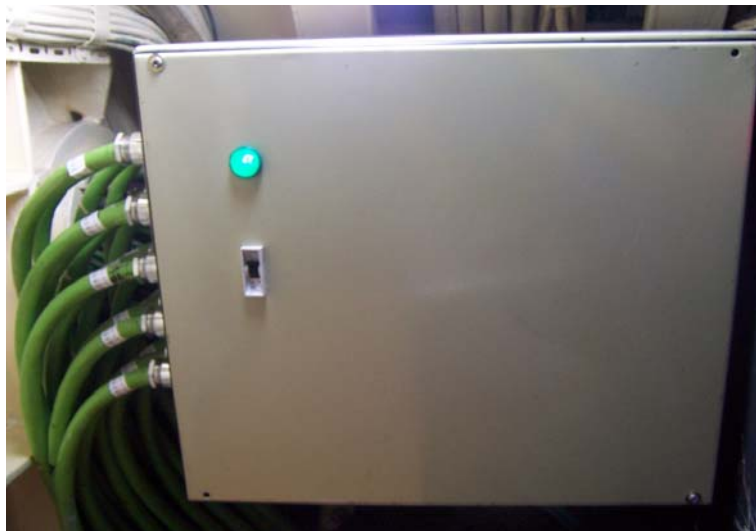
Figura 2.2.- Tablero eléctrico de voltaje
