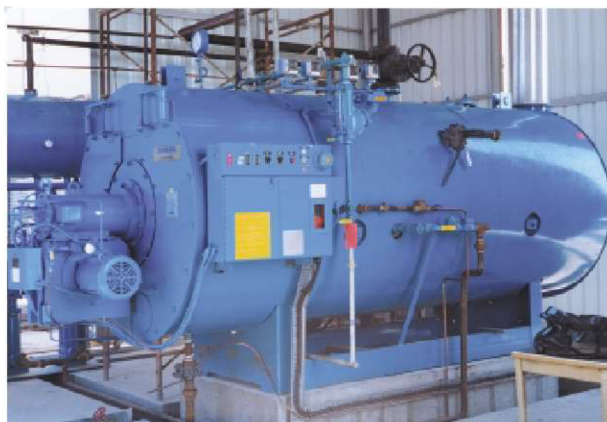
FIGURA 6.1.4. Caldera de 200 BHP a búnker marca YORK SHIPLEY
