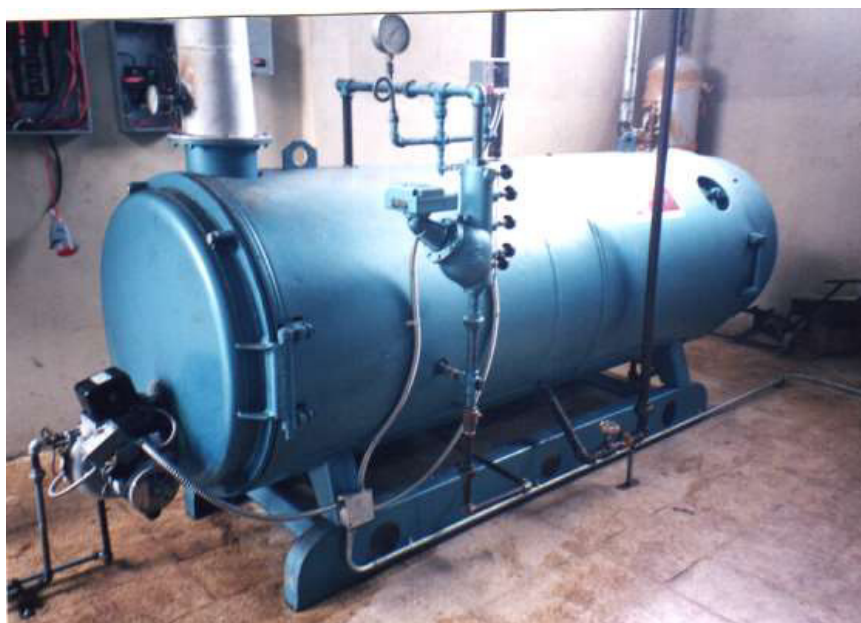
FIGURA 6.1.2. Caldera de 50 BHP a diesel marca ADUM CONSTRUCCIONES MECÁNICAS
