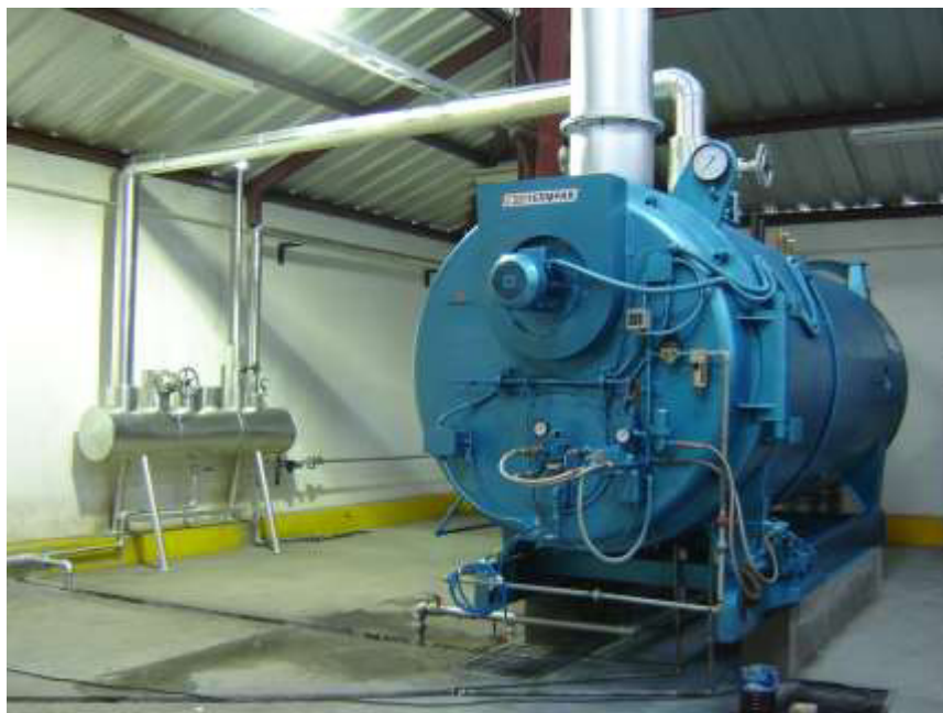
FIGURA 6.1.3. Caldera de 150 BHP a diesel marca TERMPAK
