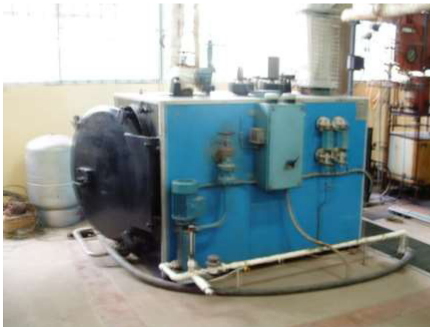
FIGURA 6.1.1. Caldera de 30 BHP a diesel marca THOMPSON COCHRAN BOILERS
