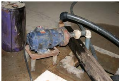
FIGURA 3.17 BOMBA PARA CISTERNA GENERAL DE LLENADORES
