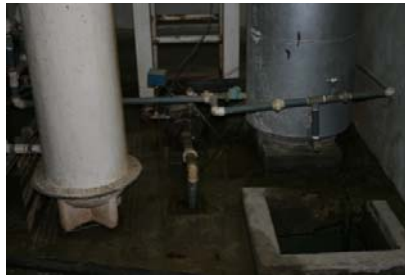
FIGURA 3.15 BOMBA CISTERNA TORRE DE ENFRIAMIENTO
