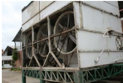
FIGURA 3.12 TORRE DE ENFRIAMIENTO
