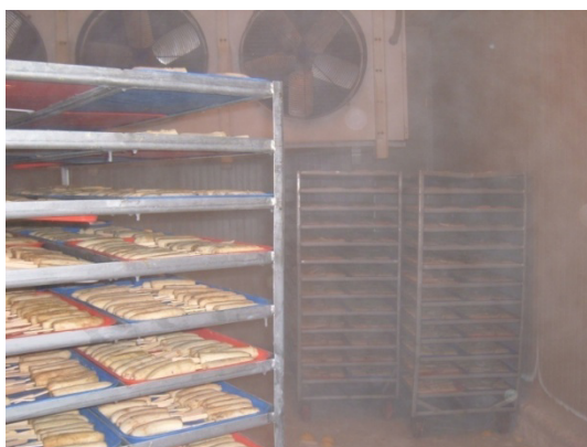
FIGURA 1.8 CUARTO DE ENFRIAMIENTO.
